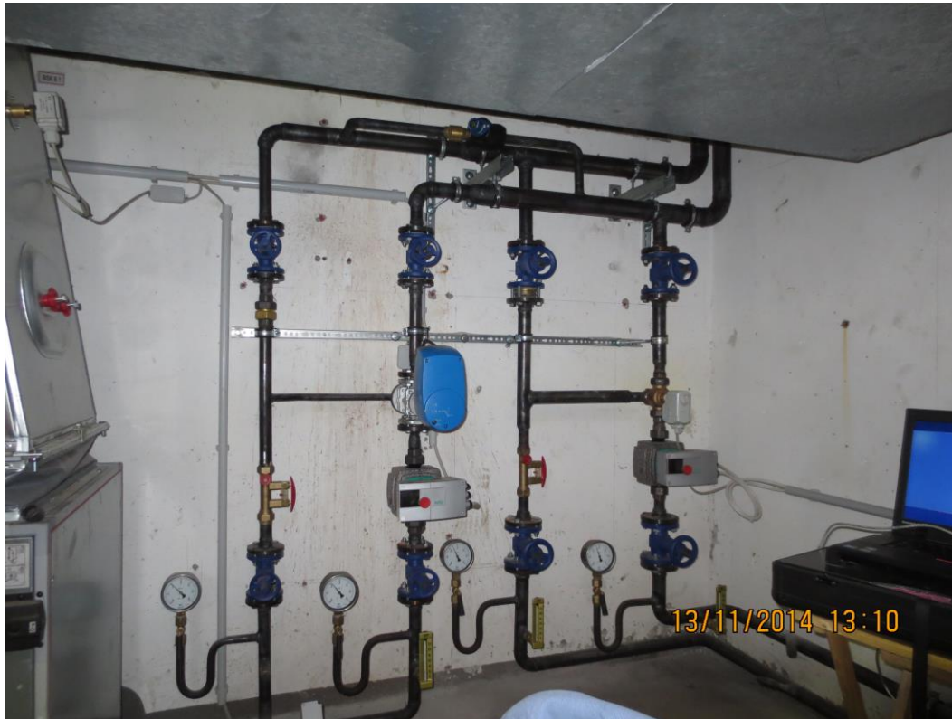
Pumpengruppe Schwimmbad und Umkleide
