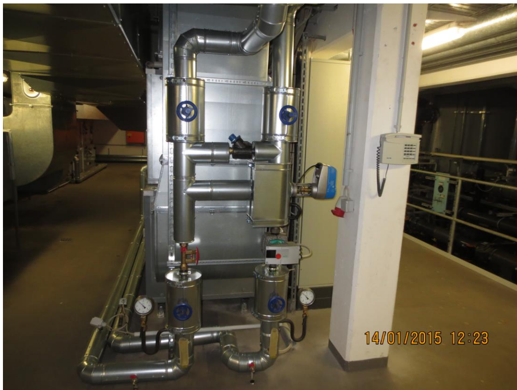
Pumpengruppe gedämmt mit Blechmantel
